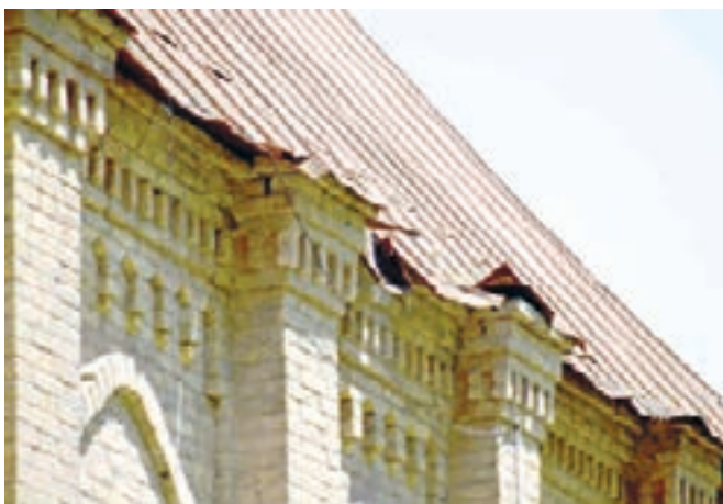
Крыша исторического здания церкви в Ташкенте имеет многочисленные повреждения
